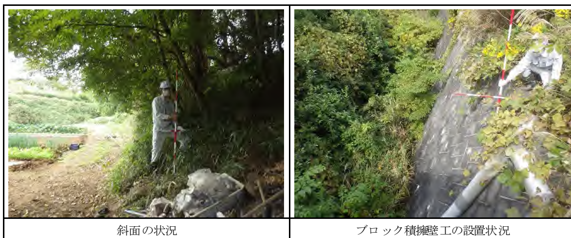
写真 9.8-1 土砂災害警戒区域の状況
