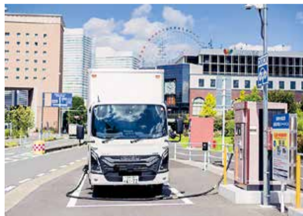
日本初のEVトラックも利用可能な公道上急速充電ステーション
