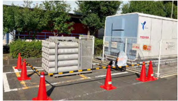
窒素カードル設置
