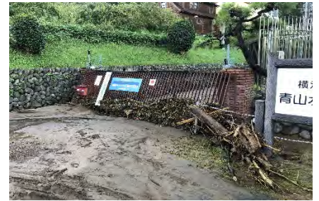
【令和元年10月台風19号による被災状況】 (青山水源事務所入口)
