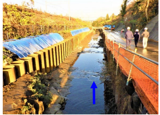
護岸改修、橋梁架替え、用地補償 (今井川：保土ヶ谷区権太坂一丁目)
