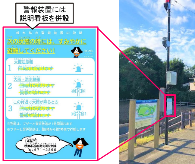
親水拠点警報装置
