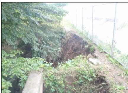
鉄道脇の河岸崩落 （JR 東海道線、横須賀線）
