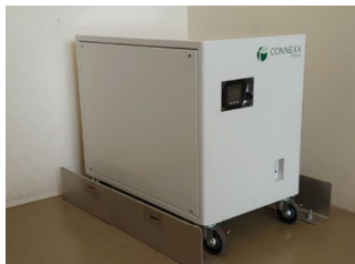
地域活動拠点「みなまきラボ」 にある蓄電池
