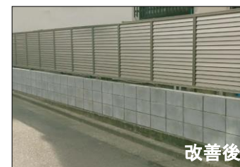
ブロック塀等の改善
