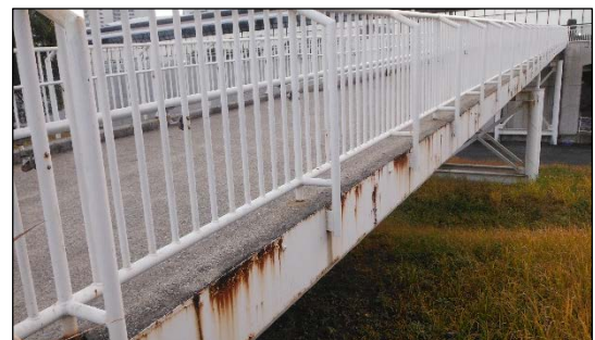
【仮設デッキの劣化状況】
