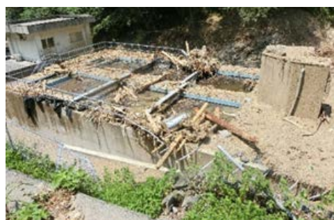
平成30年7月豪雨による 浄水施設の被災状況（愛媛県宇和島市）
