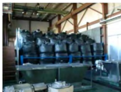
小雀浄水場の既設活性炭設備
