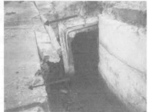
液状化による被害
