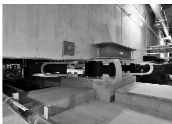
免震・制震装置
