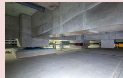
免震ピット（地下）
