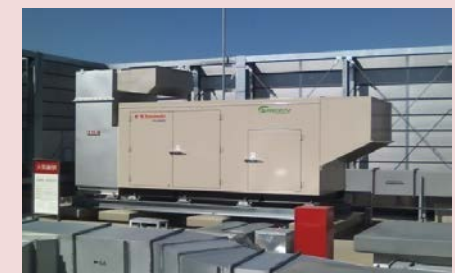
自家発電用発電機（屋上）
