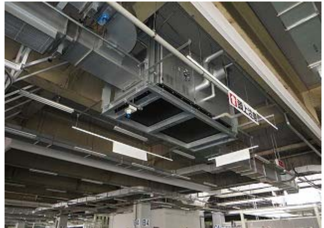
①空調設備
