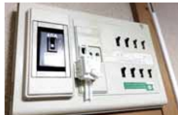
町内会館への感震ブレーカーの設置
