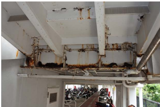
錆びの進行（1986年完成 市営駐輪場内）
