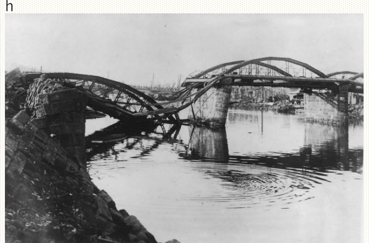
震災による豊國橋の被害写真。橋台や橋脚が傾き、桁材が崩落していることが確認できる。港橋は手前にあると思われる。
