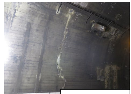
損傷(ひび割れ)
