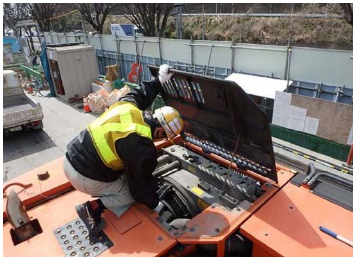
写真 4-6 環境保全のための措置の実施状況（定期点検・整備①）
