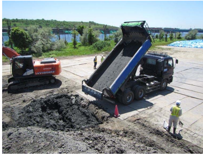
写真 2.4.3-1(4) 環境保全のための措置の実施状況（建設発生土の再利用①）
