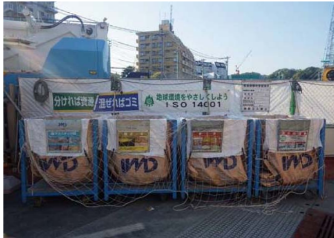
写真 2. 4. 3-1 (1) 環境保全のための措置の実施状況 (建設廃棄物の分別処理)
