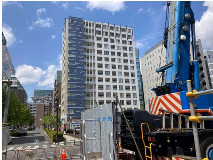
写真 2. 4. 4-1 (3) 環境保全のための措置の実施状況（建設機械稼働箇所への仮囲いの設置）
