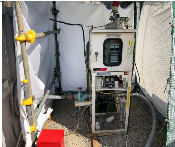
写真 2. 4. 4-4 環境保全のための措置の実施状況（濁水処理設備による排水処理）
