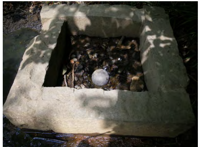
11 池南部ポンプ施設からの流入部 (湧出部 2)
