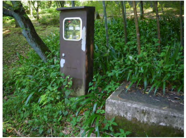
22 中池流入湧水点のポンプ施設
