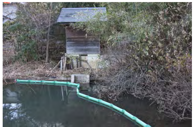
18 池ポンプ施設
