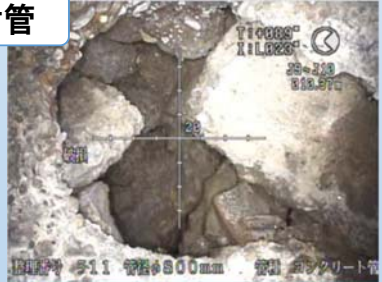
取付管異常（閉塞不良）
