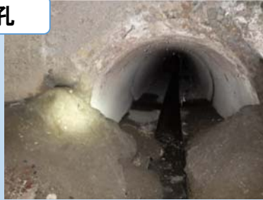
管口の破損・堆積
