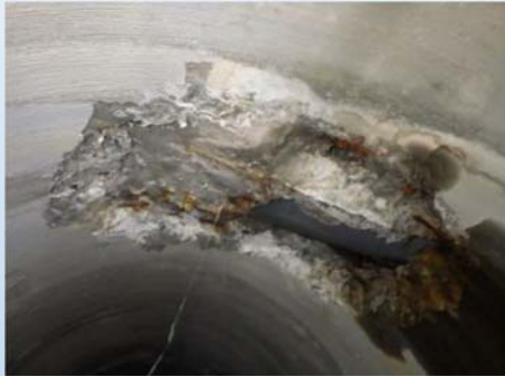
破損した下水道管路
