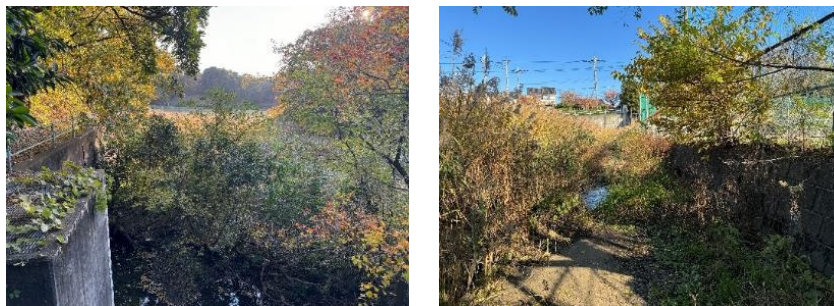
図 2-1 貯留機能が低下している施設
