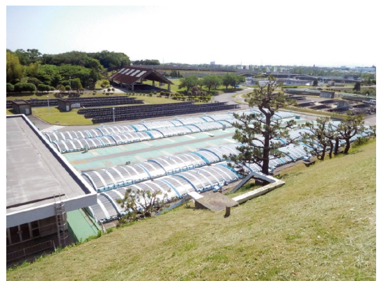
小雀浄水場2系濾過池覆蓋型太陽光発電設備
