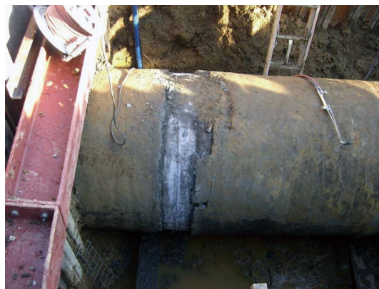
田谷町配水管漏水事故 亀裂が入った口径1,200mm管
