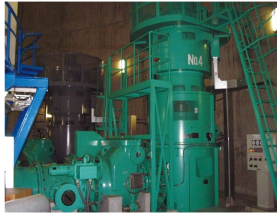
小雀浄水場流量制御用可動羽根ポンプ（揚水ポンプ）
