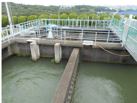
西谷浄水場着水井
