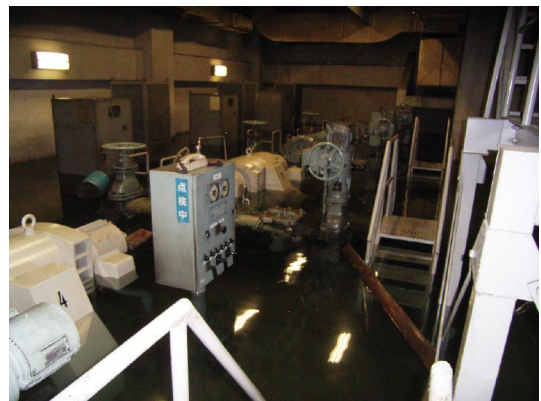
笹下ポンプ場地下の冠水状況
