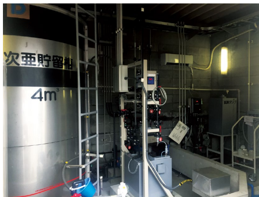
鶴ヶ峰沈殿池塩素注入設備
