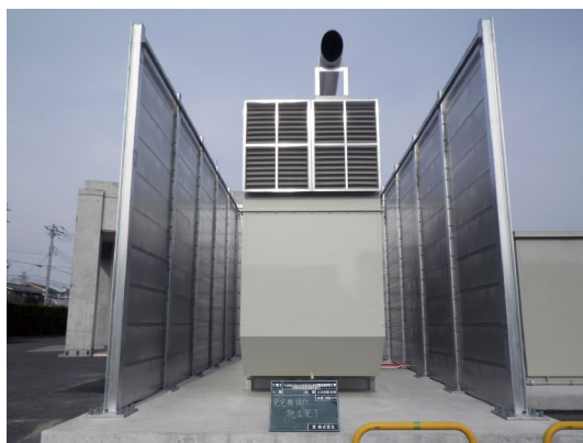
上永谷配水池の非常用自家発電設備
