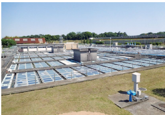
小雀浄水場2系沈殿池太陽電池搭載型フロート遮光装置
