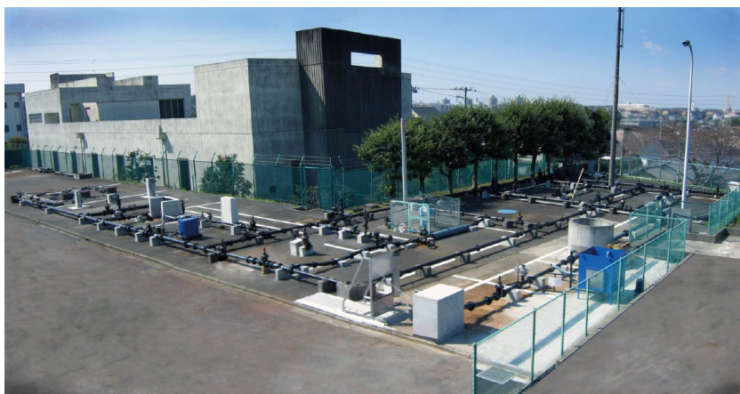
西谷管路研修施設
