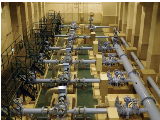
金沢配水池ポンプ場内部
