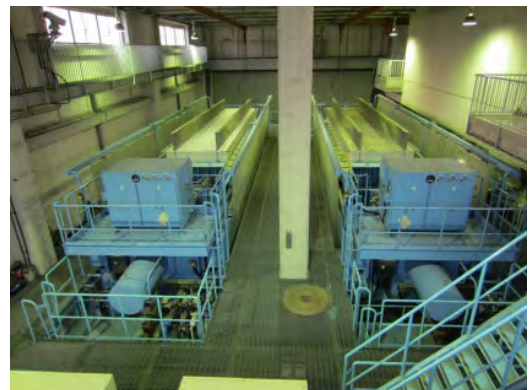
図 5.10 排水処理施設
