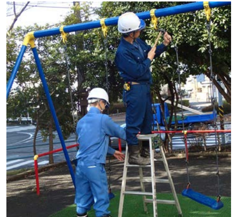
【ブランコ吊金具の点検】
