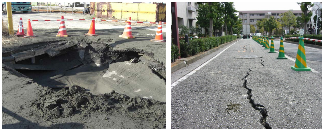
図 2-2 8 東日本大震災後の市内の被害状況
