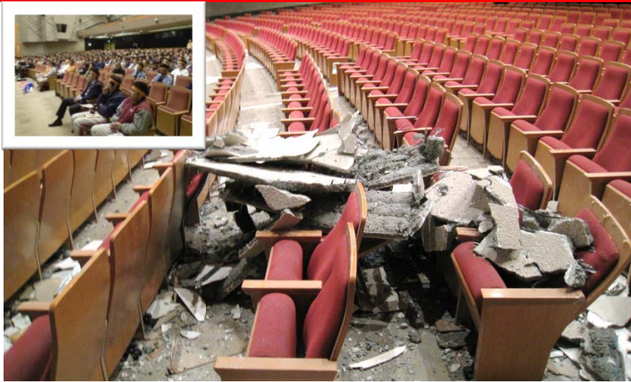
市民ホールの天井落下
