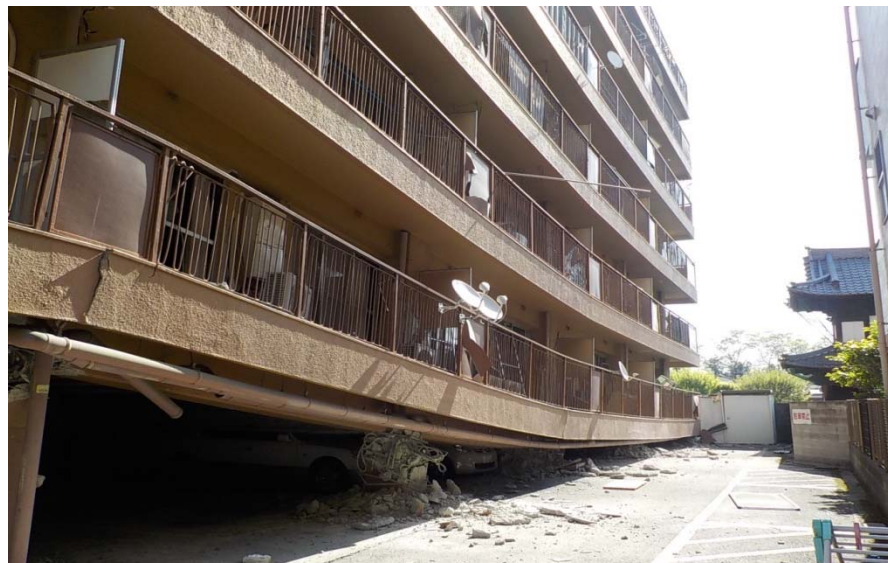
建物倒壊（マンション）
