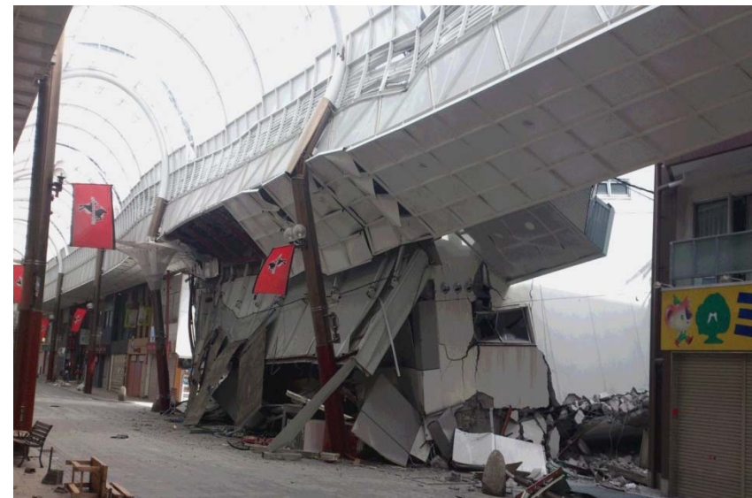
建物倒壊（商店街アーケード）
