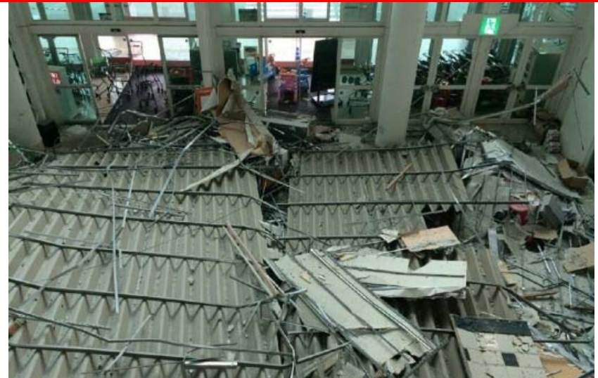
ショッピングセンター天井崩落
