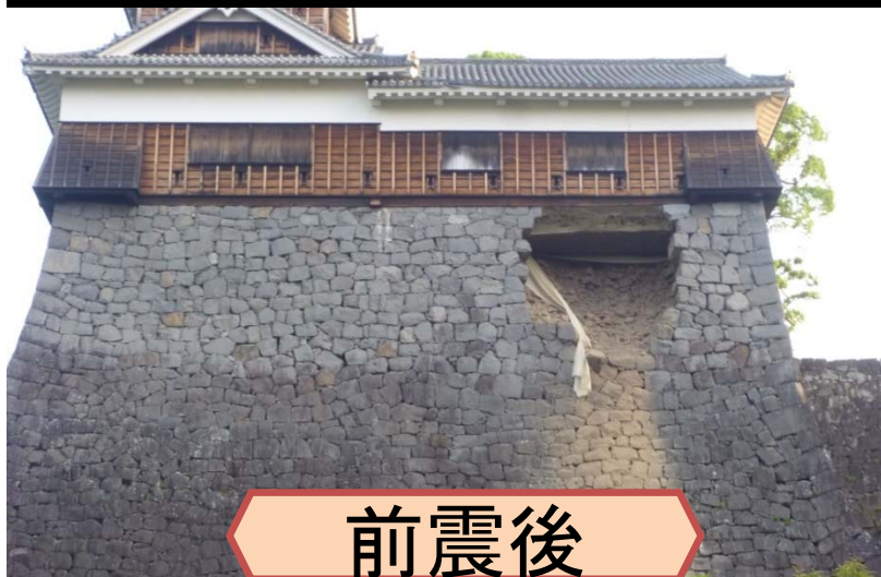
飯田丸五階櫓の石垣崩落
