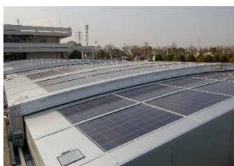
小雀浄水場ろ過池 太陽光発電設備
