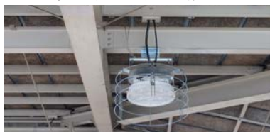
屋内運動場照明 整備例
