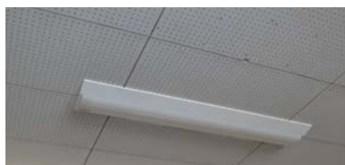
普通教室照明 整備例
