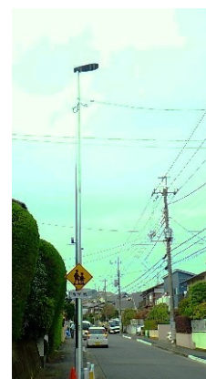
道路照明 (導入推進中)
