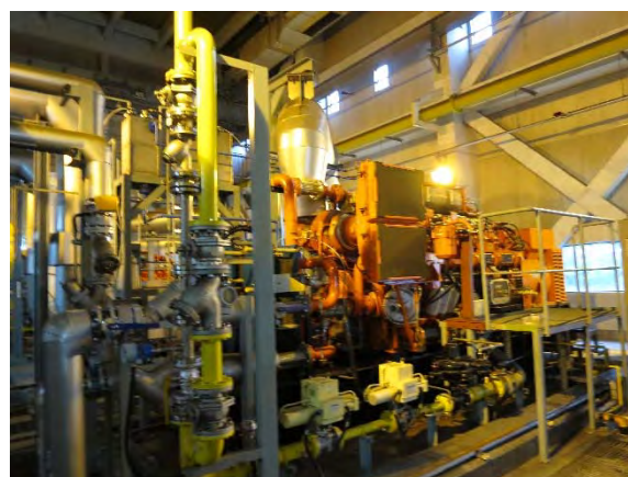
消化ガス発電
