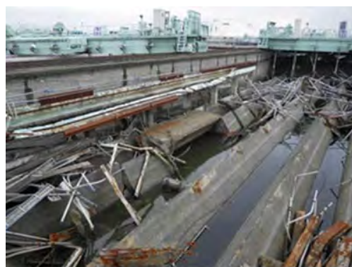
津波により破壊された水処理施設 (東日本大震災 宮城県仙台市)
