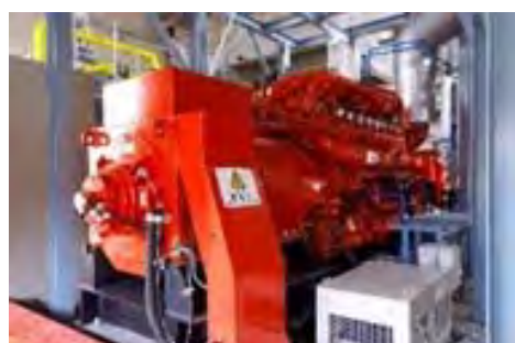
消化ガス発電機
