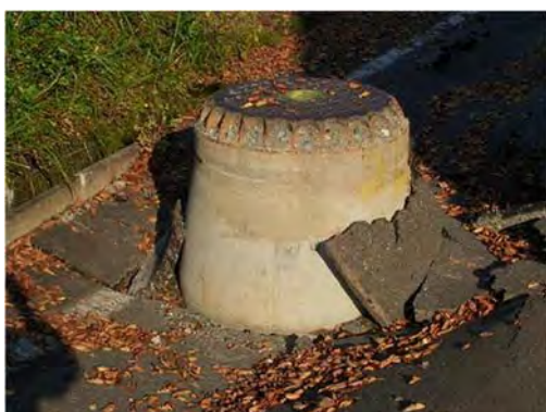
地盤の液状化によるマンホールの浮上 (中越地震 新潟県川口町)
