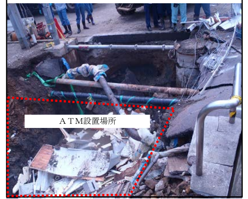
陥没状況及び他企業管を含む水道管の埋設状況
