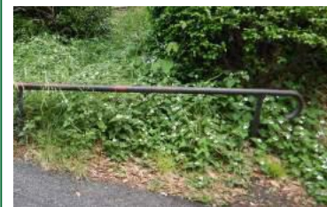
塗装がはがれた既設1段パイプ柵
