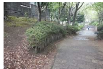
老朽化した既設土留め
